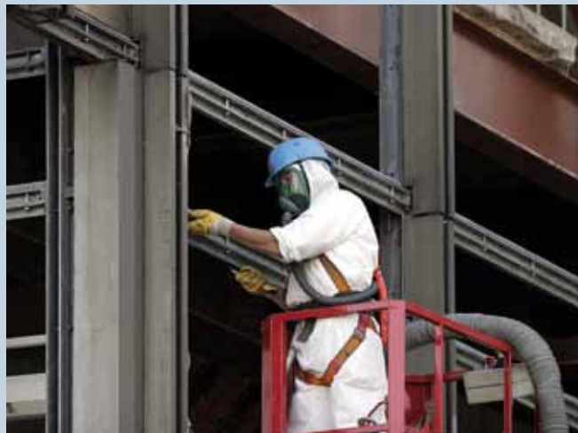
Bild 5 Entfernung von Spritzasbest als Brandschutzmasse vor dem Rückbau des Palastes der Republik Berlin [C.2]
