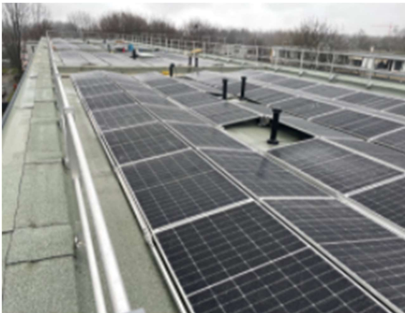
Abbildung 2020: Photovoltaik auf Flachdach
